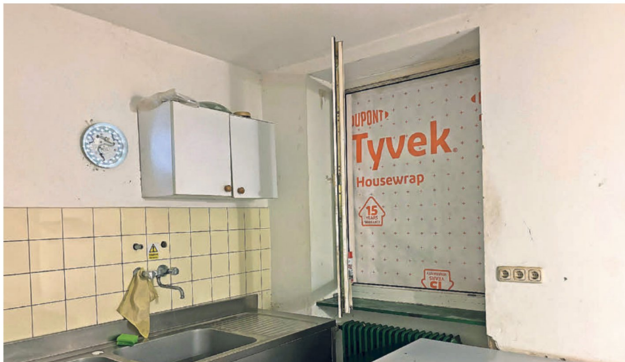
Kein Tageslicht, keine frische Luft: In den Küchen und Bädern sowie in einigen Zimmern sind die Fenster seit Monaten abgeklebt.
